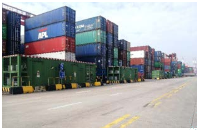
蛇口集裝箱碼頭完成建設3套岸電系統，預計每個泊位每年可以減少365噸二氧化碳，4.6噸二氧化硫和4.57噸氮氧化物排放。
