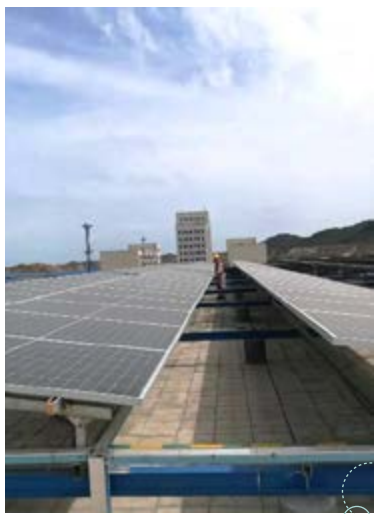
漳州招商局廈門灣港務有限公司光伏發電項目(一期)於本報告期內順利完成並投入使用。
